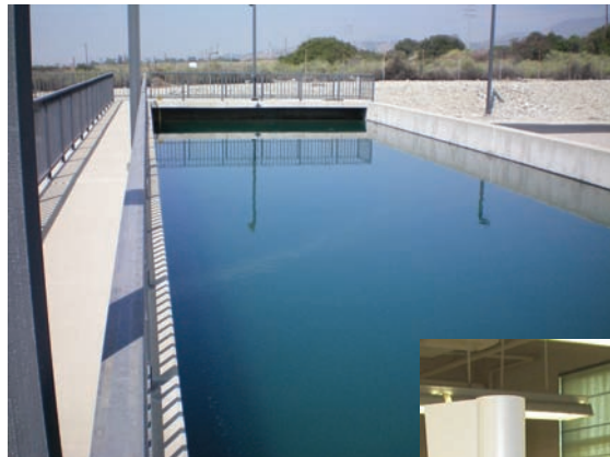
Agua de Lejos Treatment Plant
